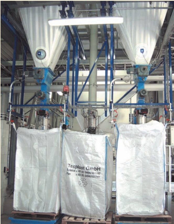
Textillagersilos mit Trogförderschnecke / Textile storage silo equipped with discharge feeding screw (copyright: FDM GmbH)
