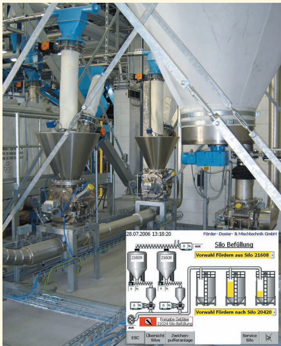
Textillagersilos Texplast in Wolfen mit Trogförderschnecke, Austragsrührwerk und Austragsschleuse – inkl. Darstellung der Anlagensteuerung / Components of the Texplast site in Wolfen/Germany: Textile storage silo equipped with discharge feeding screw, discharge agitator, rotary discharge valve – incl. screen display of PLC control (copyright: FDM GmbH)
